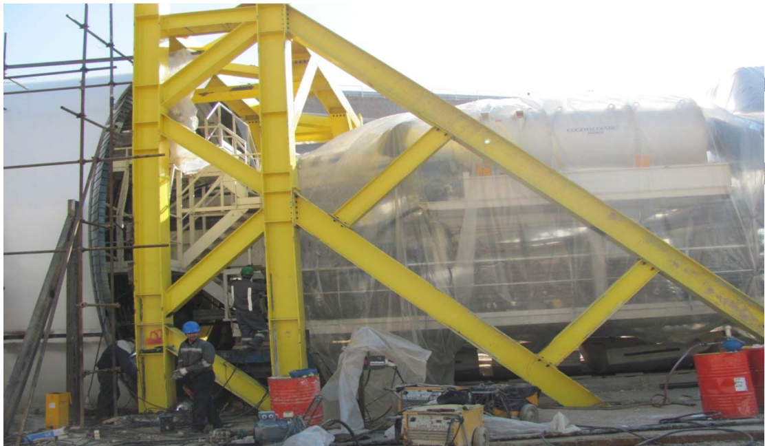
تصویر ۲ - نمایی از push frame نصب شده در شفت جنوبی پروژه خط ۲ قطار شهری مشهد
