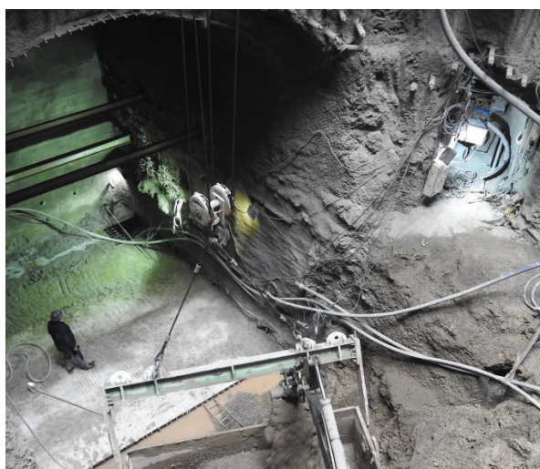
شکل ۱۲- نمایی از تونل ادیت شفت ۱ لینک ارتباطی
