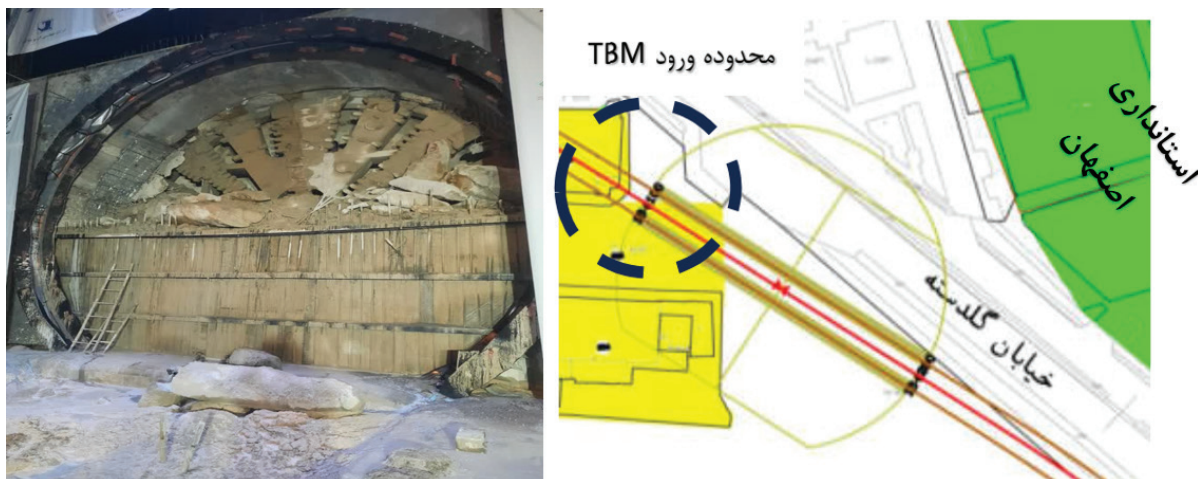
شکل ۶- حلقه آب‌بند نصب شده در محدوده ورود دستگاه حفار
