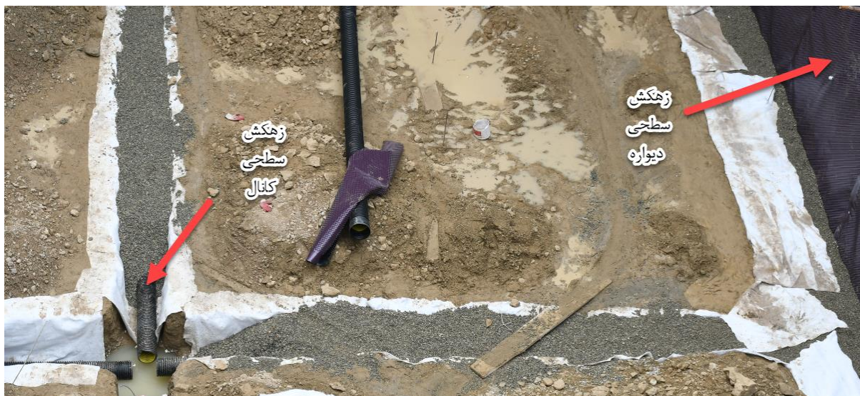
شکل ۱-۱۳- نمای از زهکش سطحی دیواره و کانال
