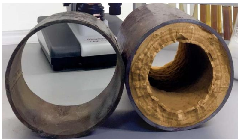
شکل ۴-۲- گرفتگی لوله بدلیل رسوبات معدنی
